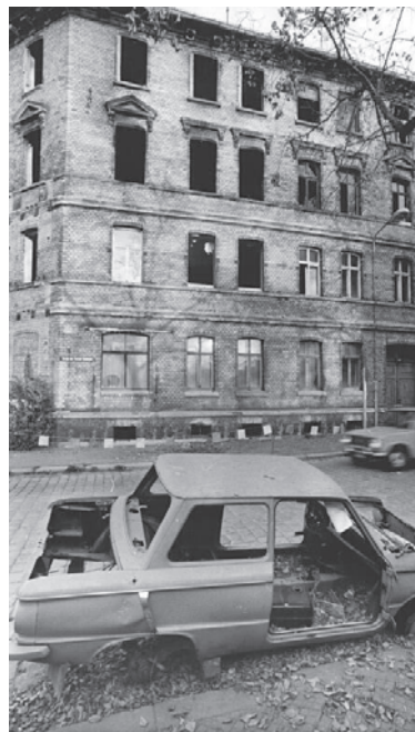
Bild: Besonders im Bereich der Altbauten entstand in der DDR ein enormer Investitionsstau. Der Slogan „Was der Krieg verschonte, überlebt den Sozialismus nicht“ machte die Runde. In den 1990er Jahren bildeten Abwanderung, Privatisierung und Sanierung enorme Herausforderungen für den Wohnungsmarkt. So auch hier in Gera (1990). Quelle: Bundesarchiv, Bild 183-1990-1023-008, Fotograf: Jan Peter Kasper
